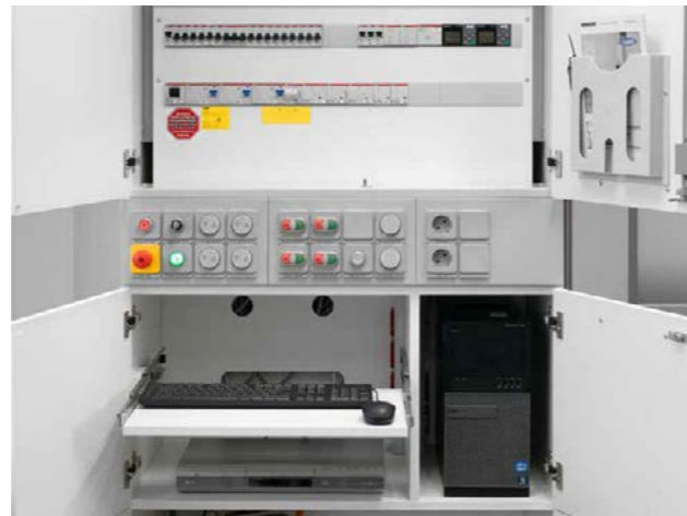
Oben: Elektro-Unterverteilung, Mitte: Integriertes Multimediafach
