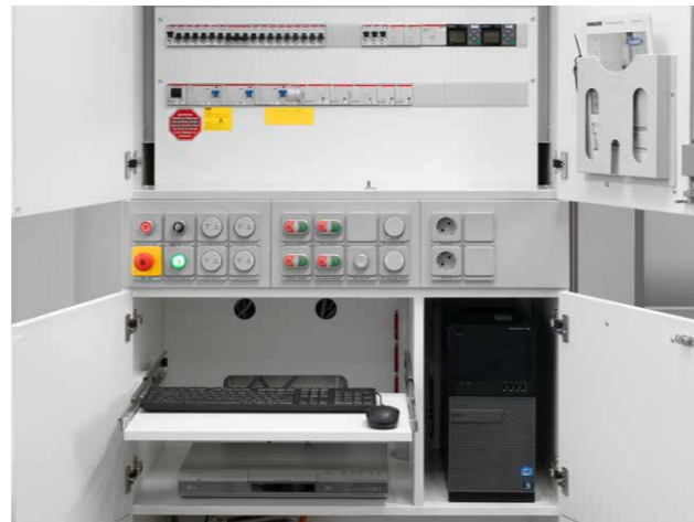
Oben: Elektro-Unterverteilung, Mitte: Integriertes Multimediafach
